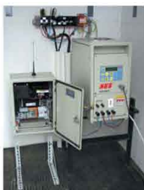
Obr.3 Objekt SKAO s nainštalovaným systémom RaM
